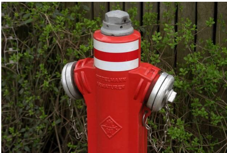
Hydrant AVK P5 – po 10 / 15 latach
